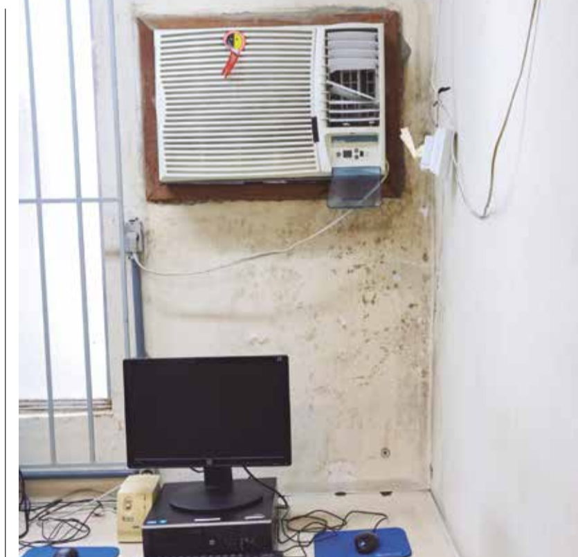
INFILTRAÇÕES são comuns. Das quatro salas disponíveis, a que recebeu a reunião com a AdUFRJ (alto) está em melhores condições
